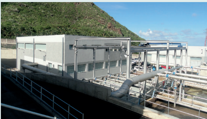
Estación de tratamientos - Aguas regeneradas - EDRAR de Valle Guerra - Tenerife
